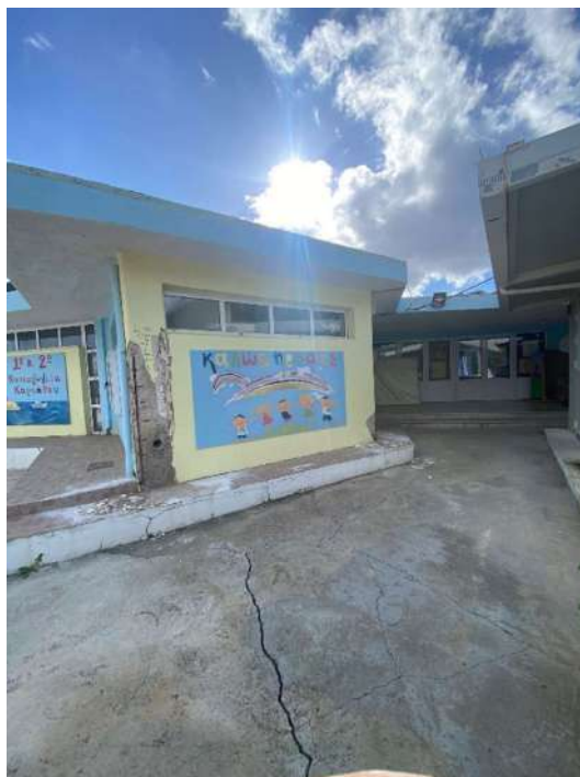
Ρηγματώσεις πλάκας διαμόρφωσης περιβάλλοντος χώρου
