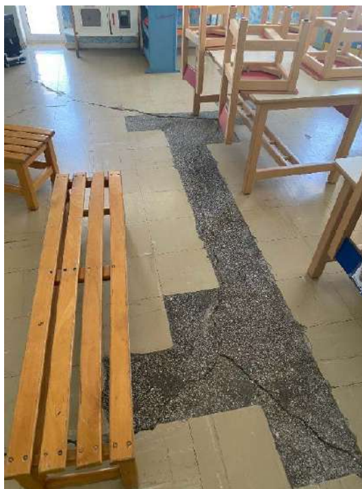
Εικόνα 7. Ρηγμάτωση δαπέδου λόγω καθίζησης της πλημμελούς συμπυκνωμένης επίχωσης.
