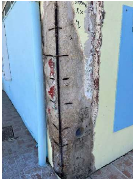
Εικόνα 4. Οξειδωμένοι οπλισμοί υποστυλώματος και θέση δειγματοληψίας.
