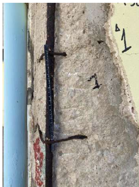
Εικόνα 5. Οπλισμοί υποστυλώματος Κ2. Έντονες διαβρώσεις
