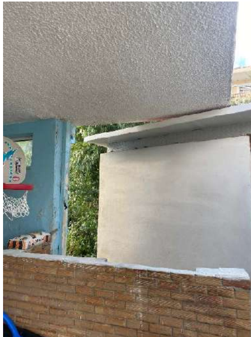
Εικόνα 6. Πρόβολος που χρήζει καθαίρεσης. Απαιτείται άμεση υποστήλωση κατά τη λειτουργία του σχολείου
