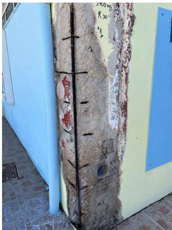
Οξειδωμένοι οπλισμοί υποστυλώματος και θέση δειγματοληψίας.
