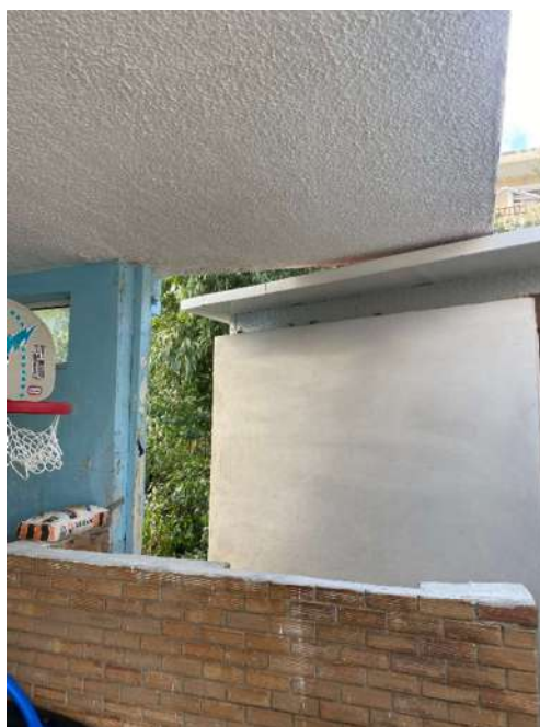
Πρόβολος που χρήζει καθαίρεσης. Απαιτείται άμεση υποστήλωση κατά τη λειτουργία του σχολείου
