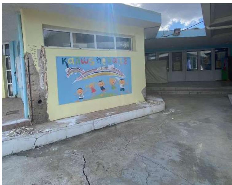
Ρωγμές στη πλάκα εδάφους μεταξύ υποστυλωμάτων K1-K2
