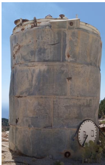
Φωτ. Μεταλλική δεξαμενή νερού
