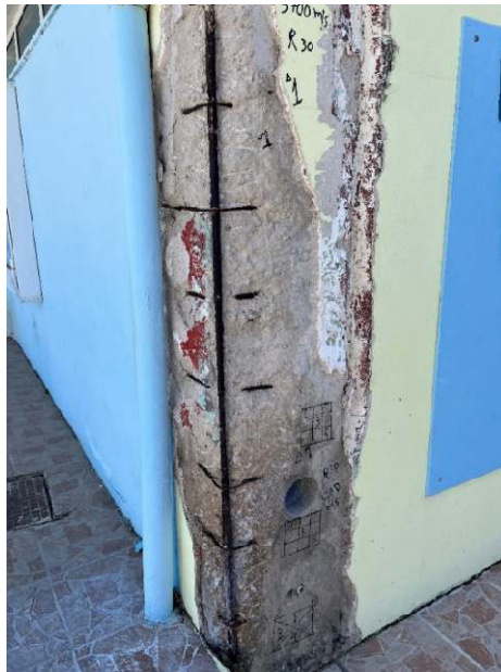
Εικόνα 4. Οξειδωμένοι οπλισμοί υποστυλώματος και θέση δειγματοληψίας.
