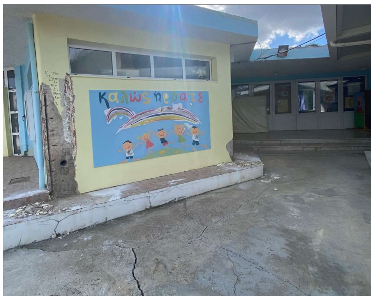
Ρωγμές στη πλάκα εδάφους μεταξύ υποστυλωμάτων K1-K2
