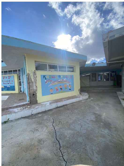
Ρηγματώσεις πλάκας διαμόρφωσης περιβάλλοντος χώρου
