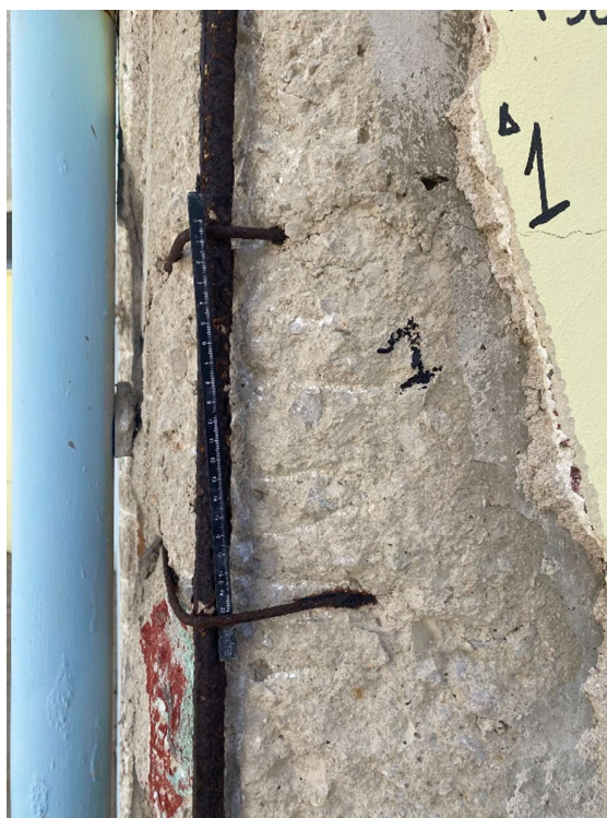
Οπλισμοί υποστυλώματος K2. Έντονες διαβρώσεις
