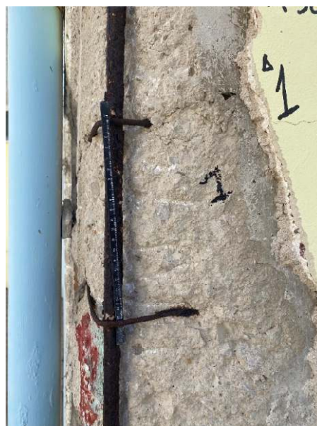
Εικόνα 5. Οπλισμοί υποστυλώματος Κ2. Έντονες διαβρώσεις
