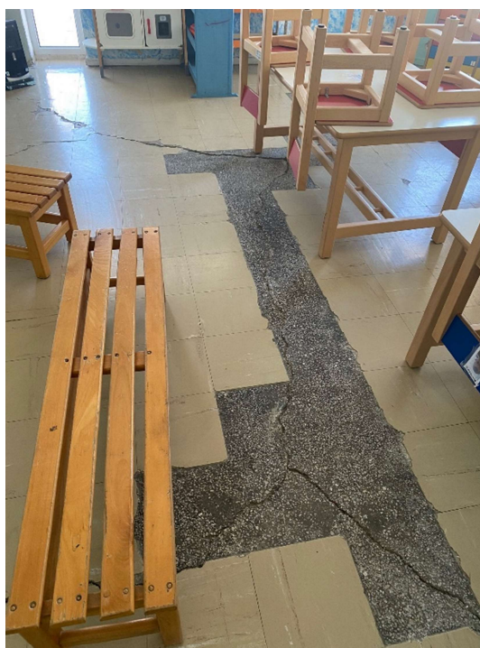
Ρηγμάτωση δαπέδου λόγω καθίζησης της πλημμελούς συμπυκνωμένης επίχωσης.
