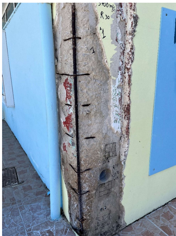
Οξειδωμένοι οπλισμοί υποστυλώματος και θέση δειγματοληψίας.
